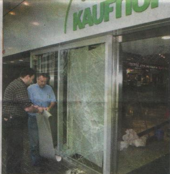
Der Morgen danach: Reparaturarbeiten an der Eingangstür des Kaufhof-Warenhauses an der Stresemannstraße. FOTO: WOLFGANG RUDOLF
